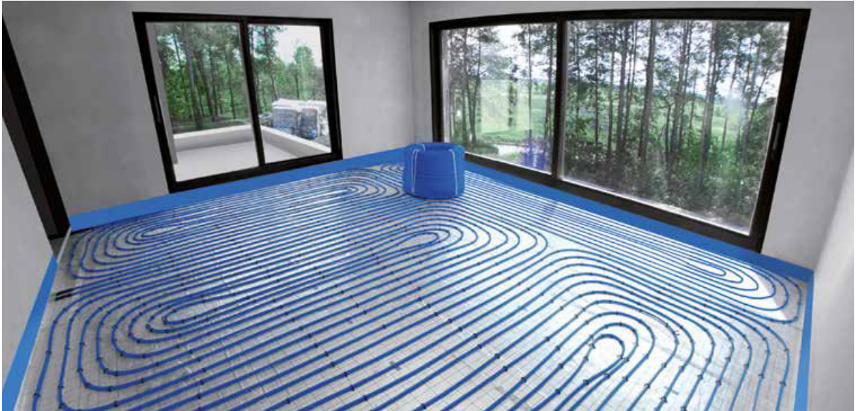
3. Ábra Padlófűtési rendszer családi házban, bluePERT csövek és KAN-therm Tacker rendszer alkalmazásával.
