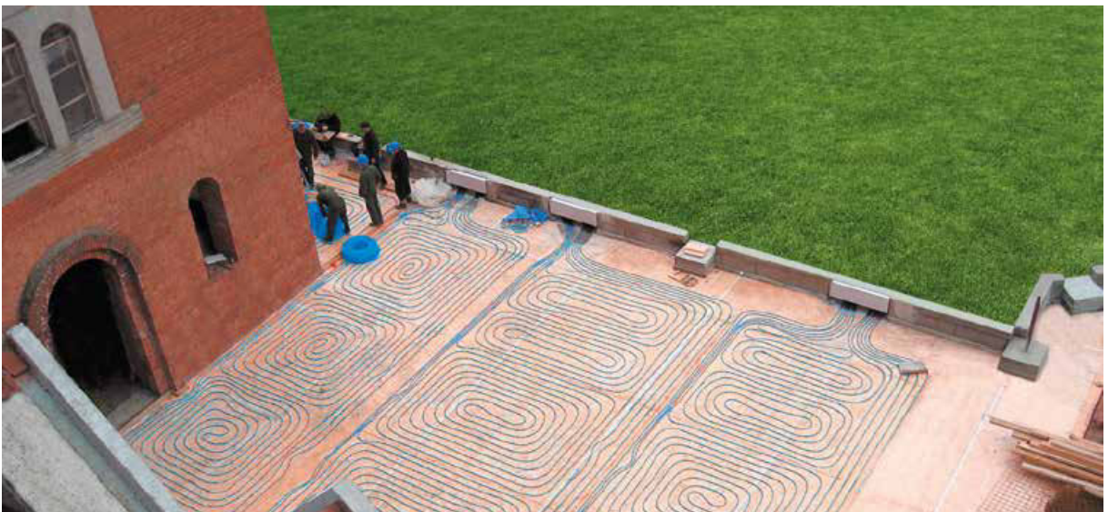
5. Ábra Kültéri terasz fűtési rendszer a KAN-therm rendszer bluePERT csövek alkalmazásával.
