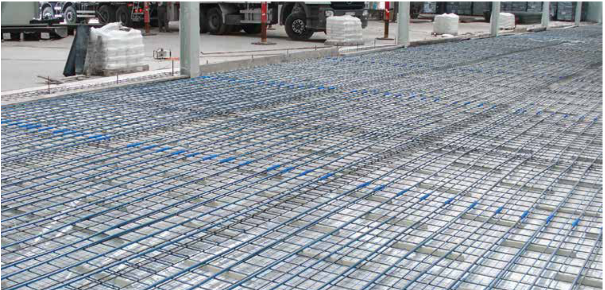
4. Ábra Padlófűtési rendszer ipari létesítményben, bluePERT csövek és KAN-therm NET rendszer alkalmazásával.
